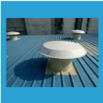
Power Roof Eq Jase Fan
