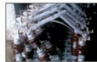
22 Kv 400 Amps A.B. Switch
